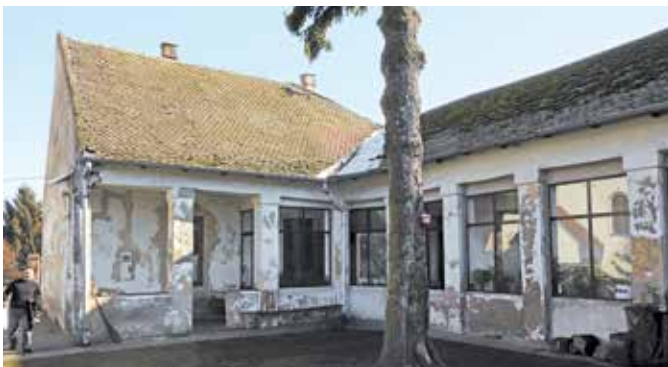
Die Gebäude der reformierten Gemeinde in Hrastin/Haraszti wurden während des Balkankrieges mehrfach beschädigt. Die statischen Probleme im Pfarrhaus sollen jetzt mit Unterstützung des GAW behoben werden.
